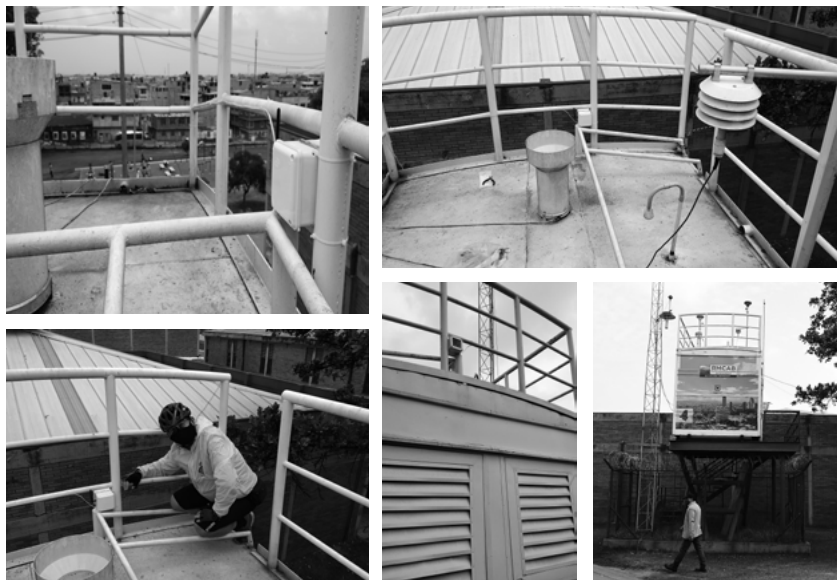
FIGURA 10. Instalación de sensores en la estación oficial Kennedy
