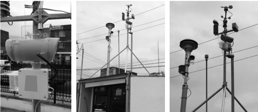
FIGURA 13. Instalación de sensores en la estación de calidad del aire de la Universidad Distrital
